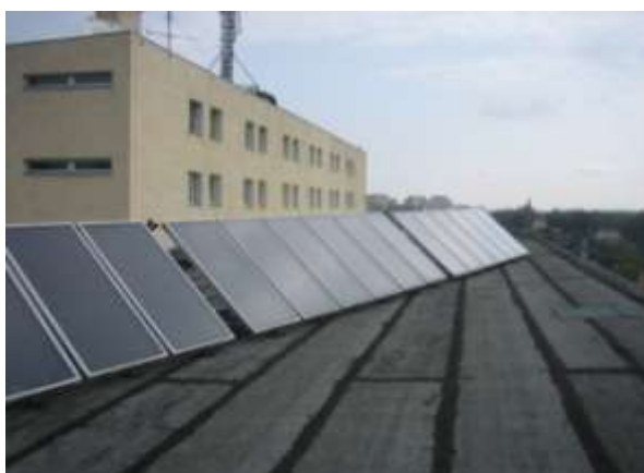
Fot. 8. Zestaw kolektorów słonecznych na budynku Specjalnego Ośrodka Szkolno Wychowawczego nr 2. (Źródło: Starostwo Powiatowe w Gnieźnie, opracowanie własne)
